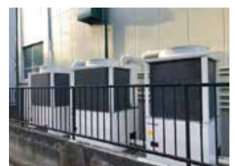
杉並センターに設置した自然冷媒機器
