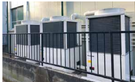
杉並センター ノンフロン冷凍機
