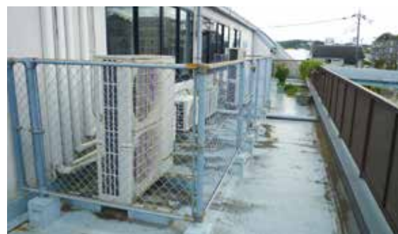
町田センター 室外機
