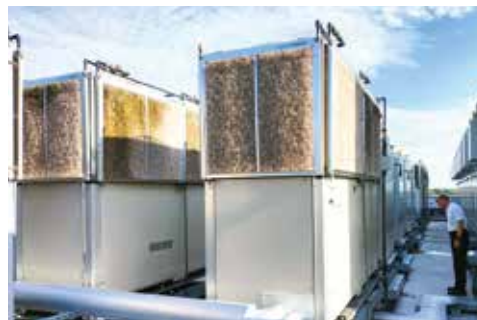
草加要冷セットセンターに導入したノンフロン冷凍機。機器を冷却する散水機には工業用水を使用しています。
