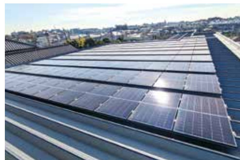
和光センター屋上の太陽光発電パネル
