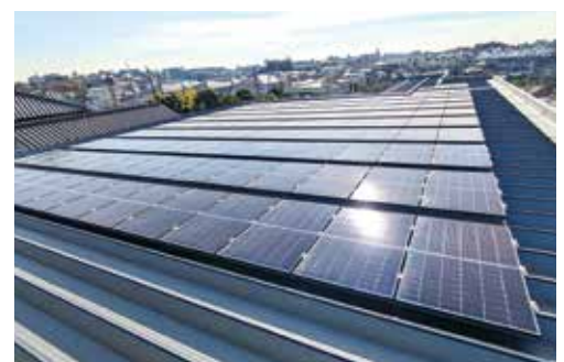
和光センターの屋上に設置した太陽光発電パネル
